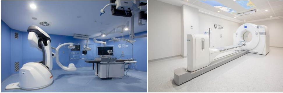
Interior quirófano, Universidad Navarra, Madrid - Sala de resonancia magnética.
