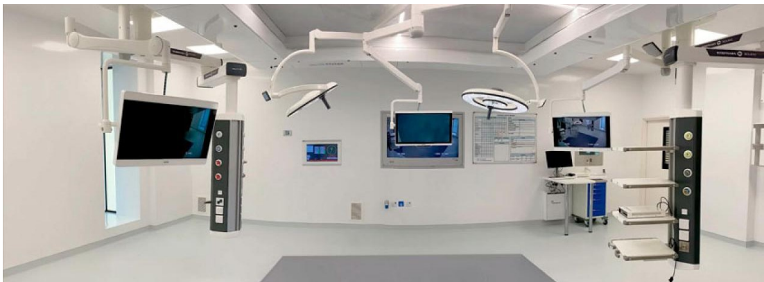
Quirófano integrado Hospital St John & St Elizabeth. Fuente: Hospitecnia.
